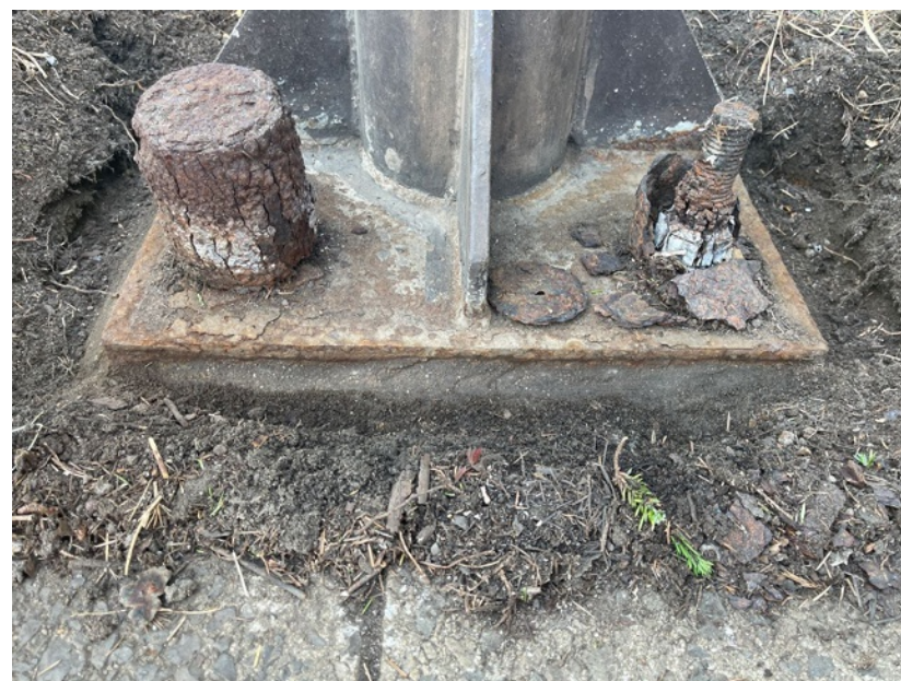
キャップ・ボルト腐食、ナットき裂・腐食
