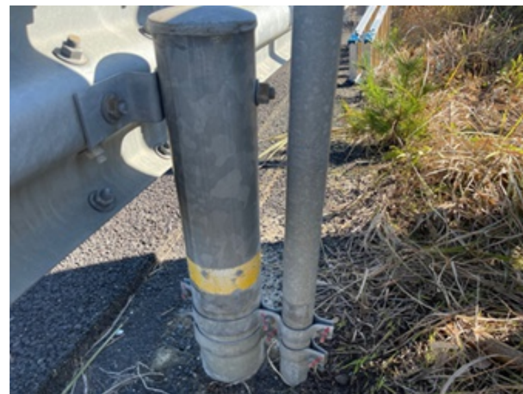
バンドの脱落
