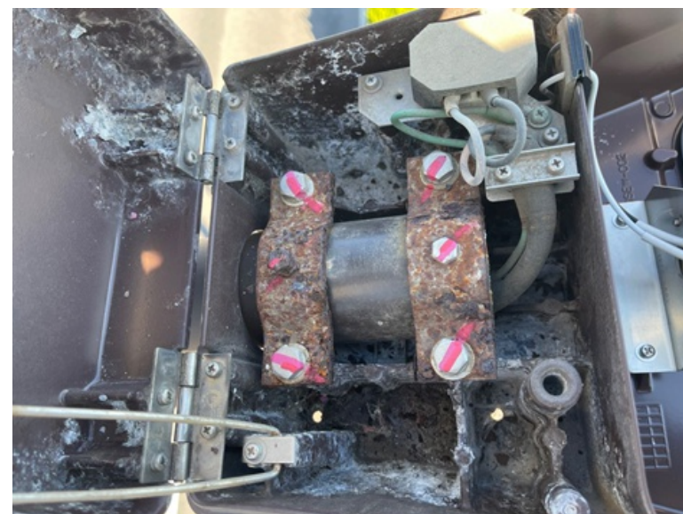
灯具取付部の腐食
