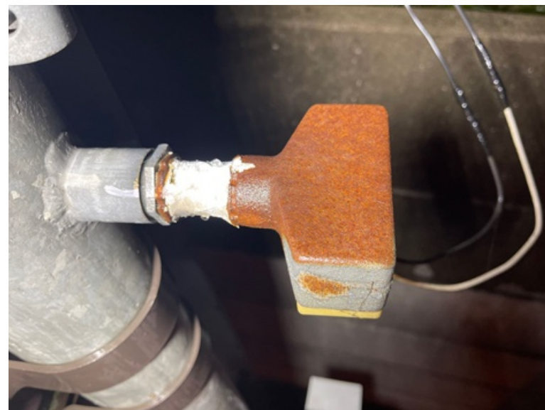
配線部分の腐食
