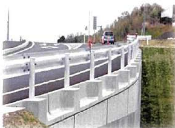
ガードレール基礎 プレガードⅡ
