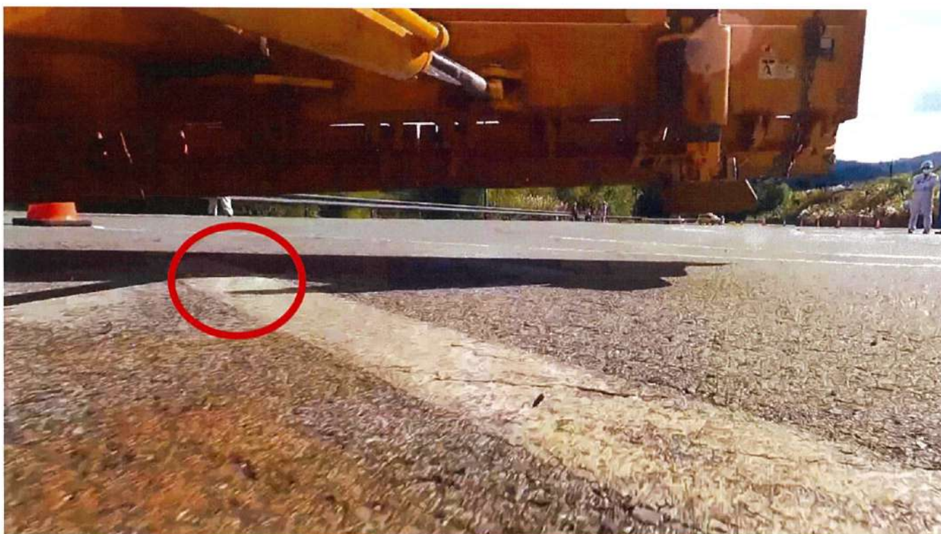
図6 実証実験の対象地（国土交通省中国地方整備局三次河川国道事務所口和除雪車両基地） （○印は障害物を想定したポイントでプラウが上昇している）
